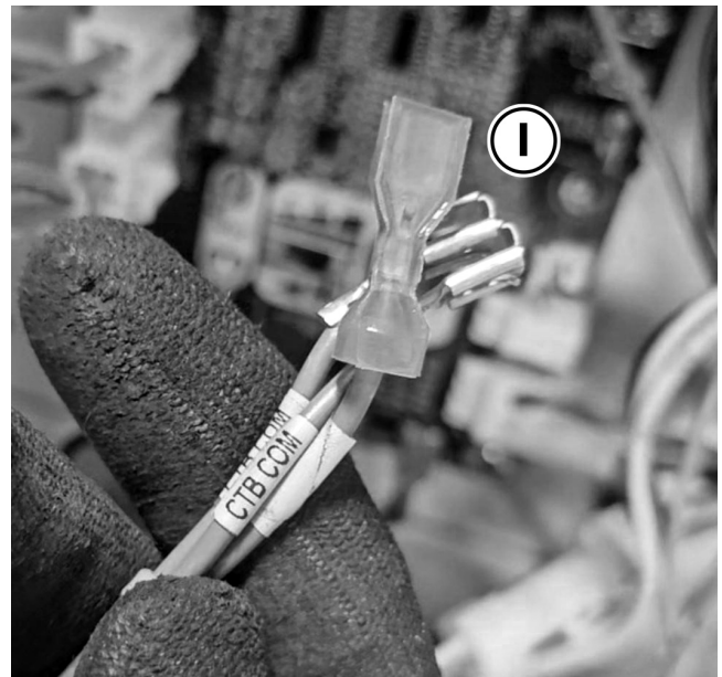
Fig. 13 — CTB COMM Wires
