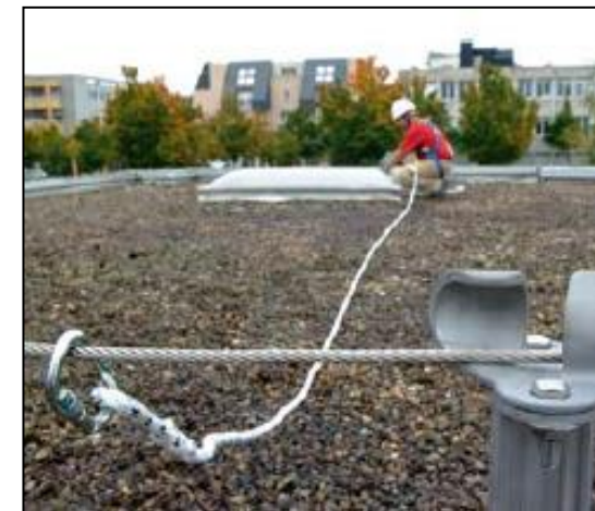
Kotevní bod na střeše
