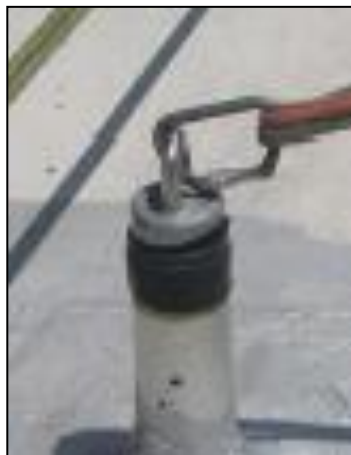
Kotevní bod na střeše
