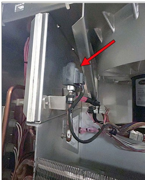
Figur 3.20 Elektronisk ekspansionsventil (EEV)
