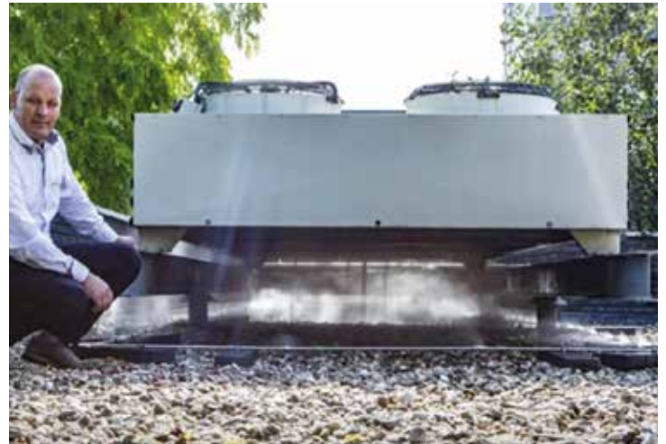
Vernevelingssysteem (pomp) in combinatie met vrijgave regelsysteem
