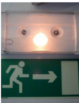
Balisateur des issues de secours
